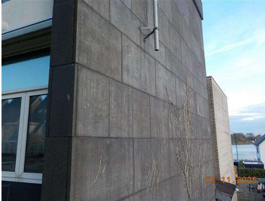
Foto 1: Bron B01, Buiten muur met asbesthoudende tegellijm
