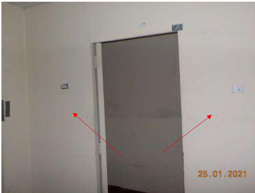
Foto 7: Bron B02, asbesthoudende wand beplating in cv ruimte, kelder
