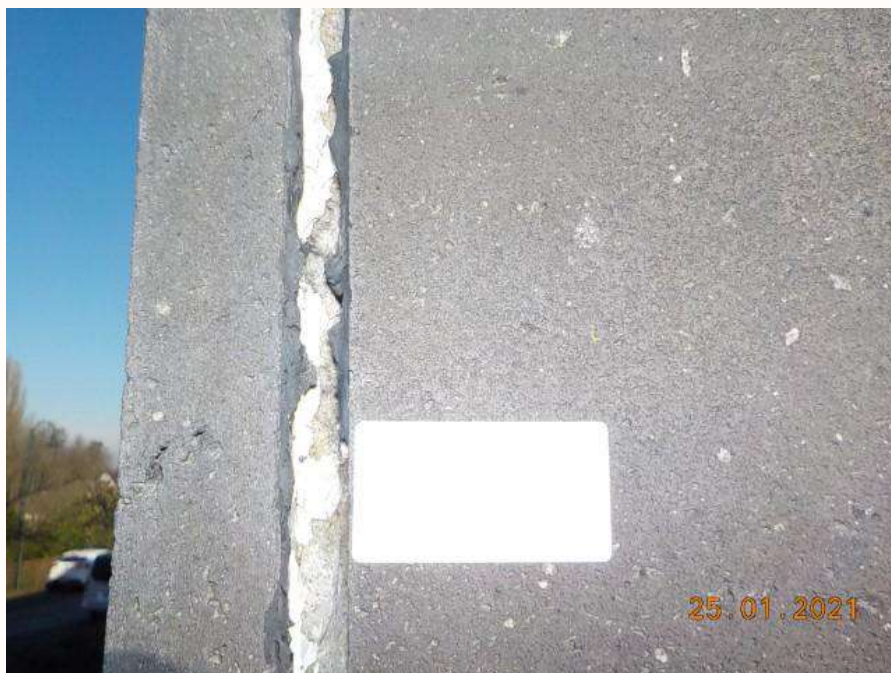
Foto 3: Bron B01, Buiten muur met asbesthoudende tegellijm
