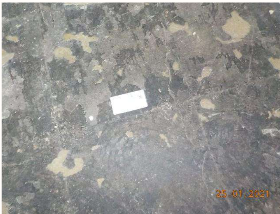
Foto 9: Bron B03, Asbesthoudende zwarte lijm, vloeren, oude deel Gemeentehuis, M06
