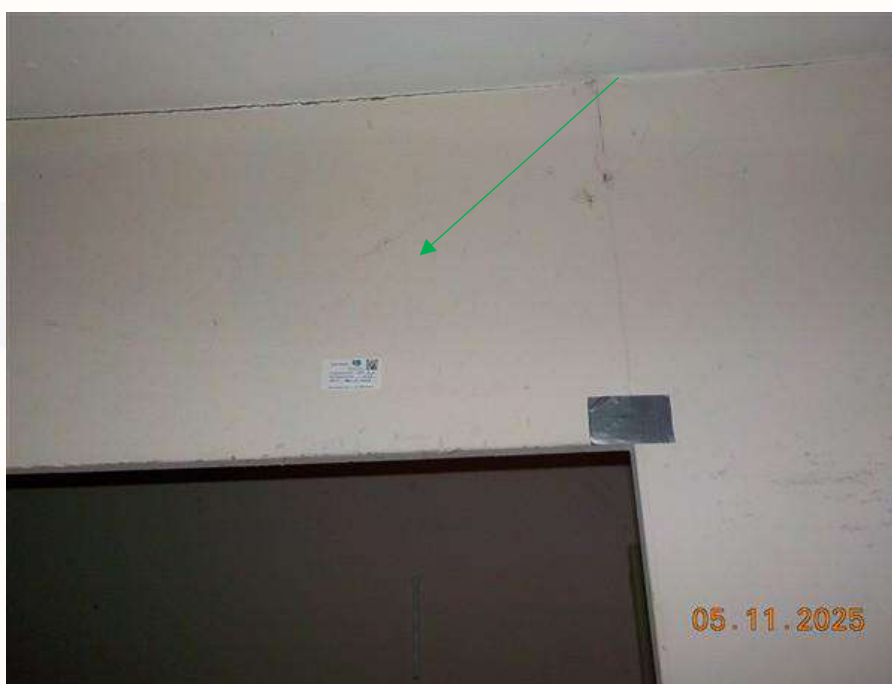
Foto 16: Bron B07, asbestvrij bovenlicht, cv ruimte kelder
