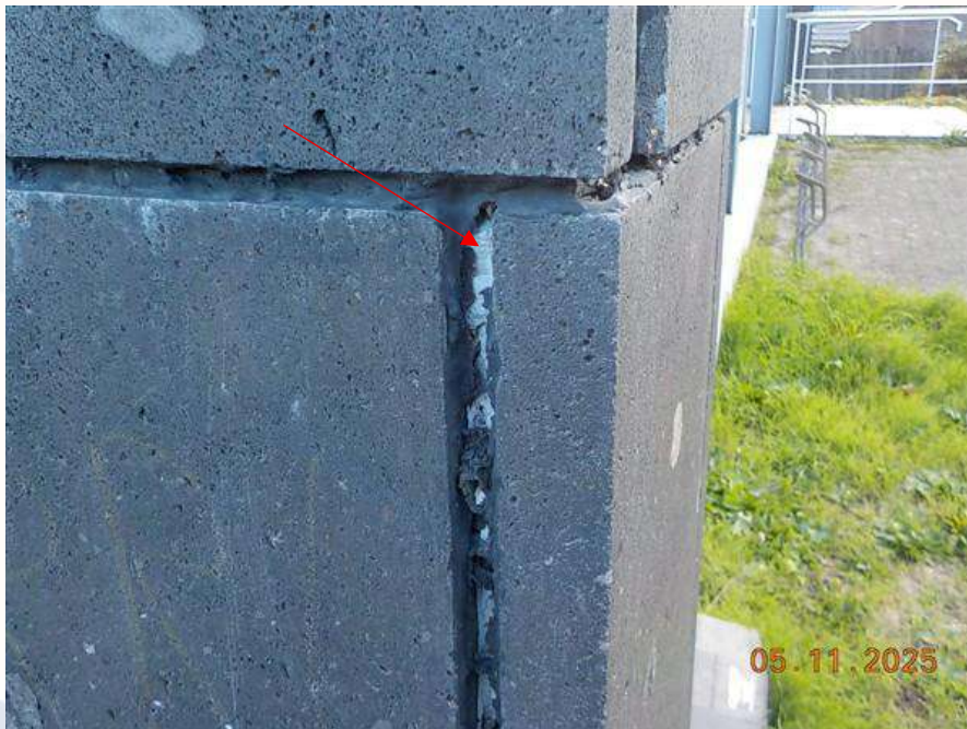
Foto 2: Bron B01, Buiten muur met asbesthoudende tegellijm
