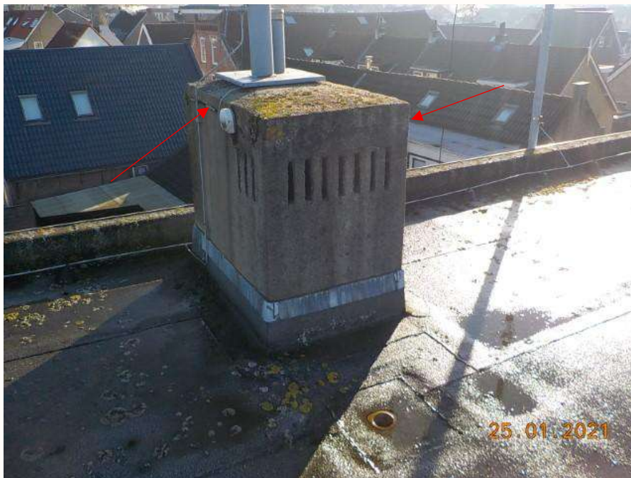
Foto 13: Bron B05, asbesthoudende kit, schoorsteen dak
