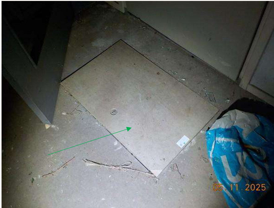
Foto 23: Bron B12, asbestvrij kruipluik
