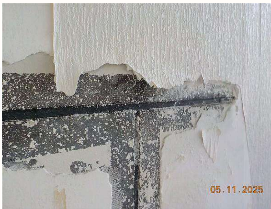
Foto 4: Bron B01, Binnen muur, achter stuklaag / behang, met asbesthoudende tegellijm
