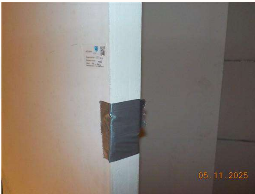
Foto 20: Bron B10, asbestvrije deur, cv ruimte kelder
