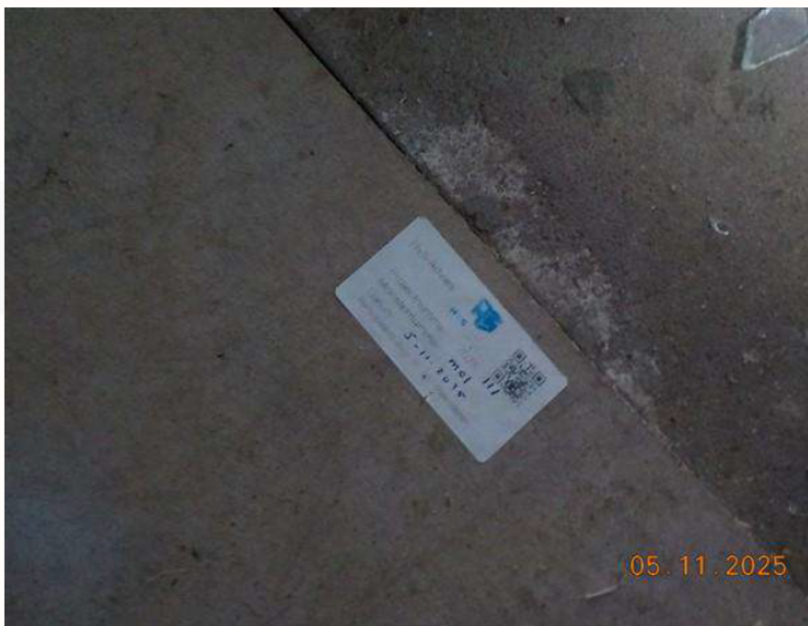
Foto 24: Bron B12, asbestvrij kruipluik
