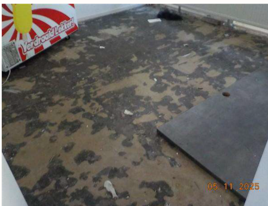
Foto 8: Bron B03, Asbesthoudende zwarte lijm op Vloeren, oude deel v.m. Gemeentehuis
