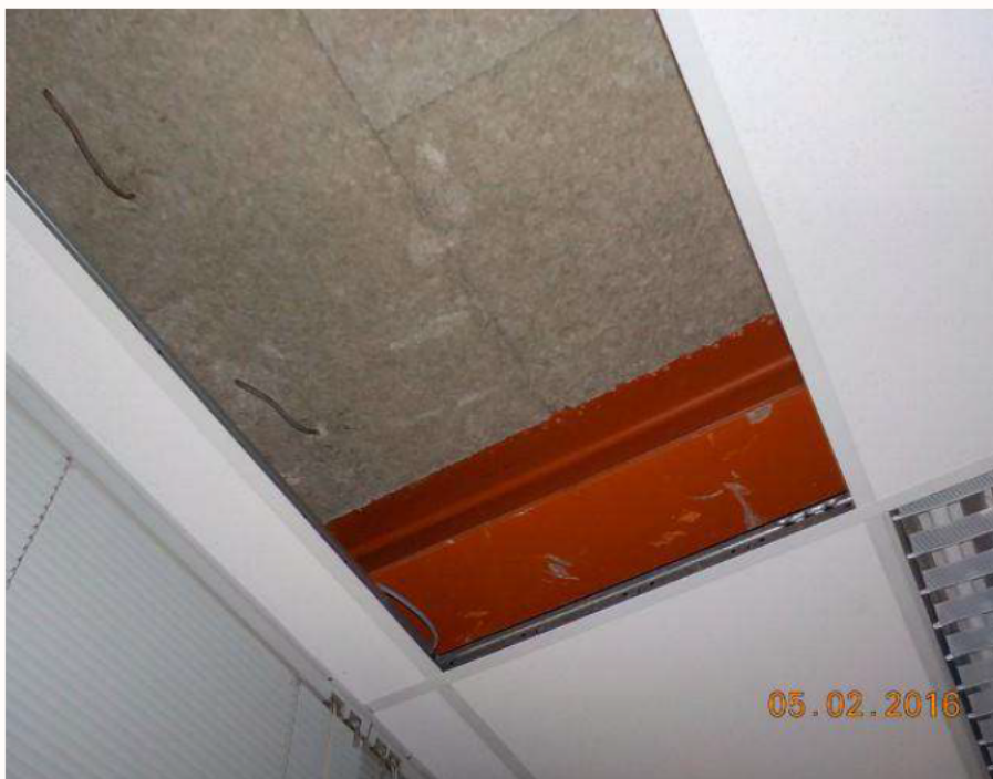
Foto 17: Bron B08, Asbestvrije houtwol cement beplating
