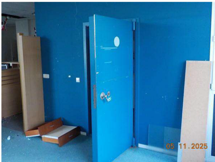
Foto 15: Bron B06, Branddeur in kantoor, vm Gemeentehuis
