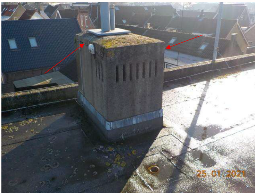
Foto 13: Bron B05, asbesthoudende kit, schoorsteen dak
