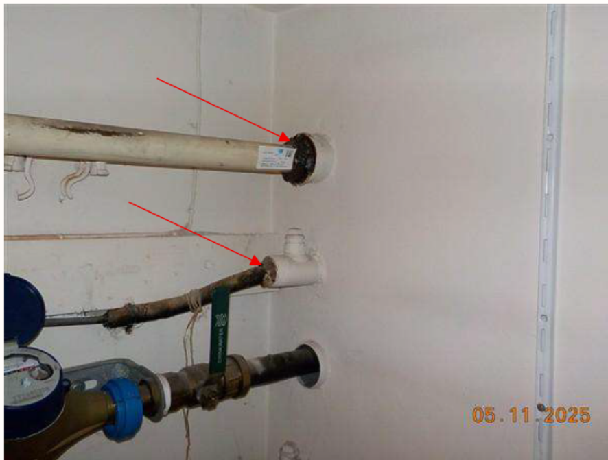
Foto 11: Bron B04, asbesthoudende zwarte kit, doorvoer
