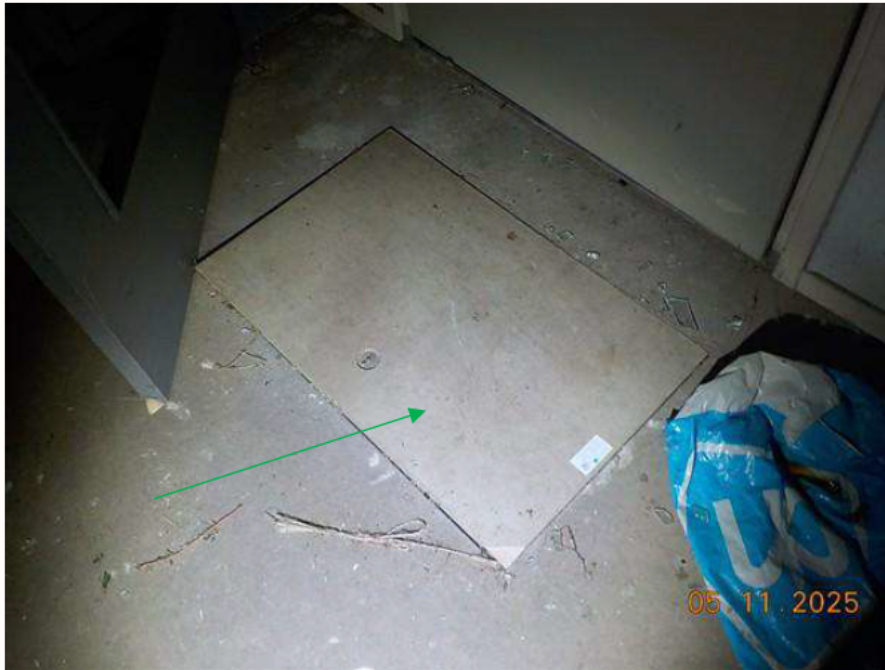
Foto 23: Bron B12, asbestvrij kruipluik
