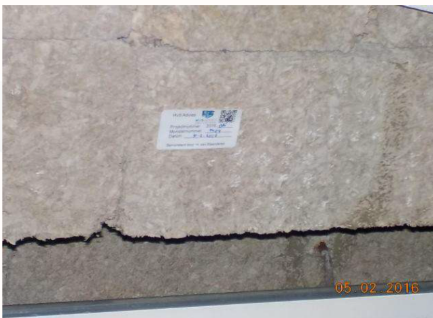
Foto 18: Bron B08, Asbestvrije houtwol cement beplating
