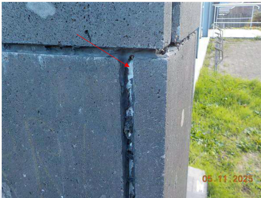
Foto 2: Bron B01, Buiten muur met asbesthoudende tegellijm
