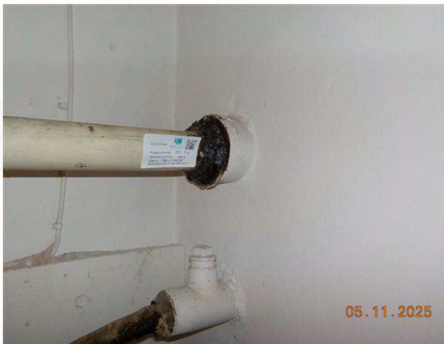
Foto 12: Bron B04, asbesthoudende zwarte kit, doorvoer
