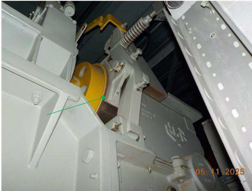
Foto 19: Bron B09, asbestvrije remschoenen liftinstallatie
