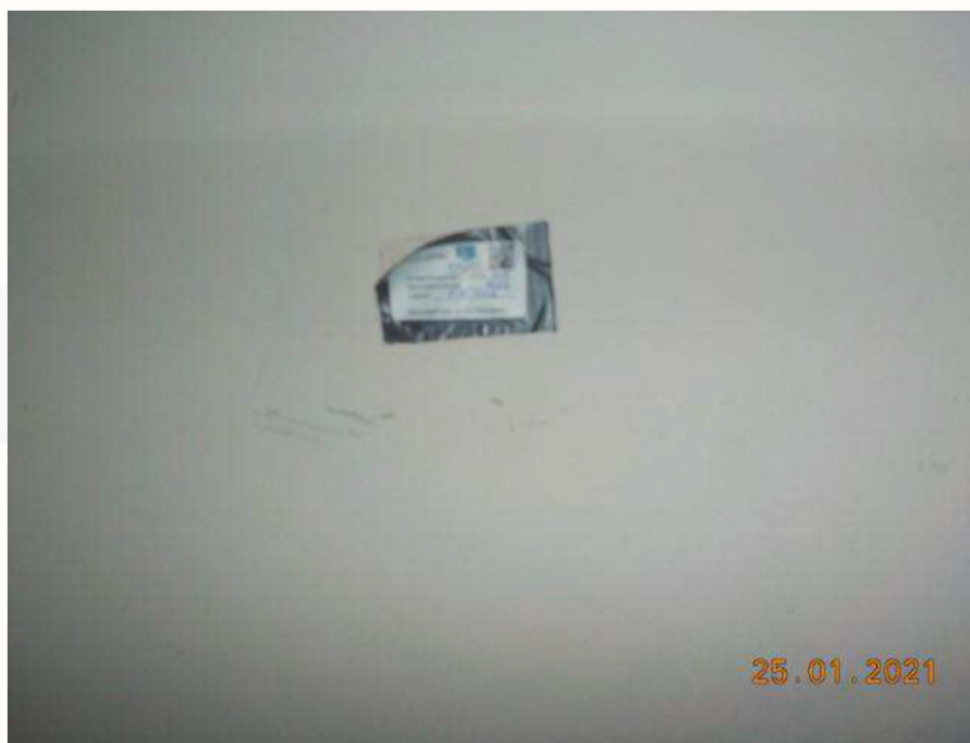
Foto 6: Bron B02, asbesthoudende wand beplating in cv ruimte, kelder
