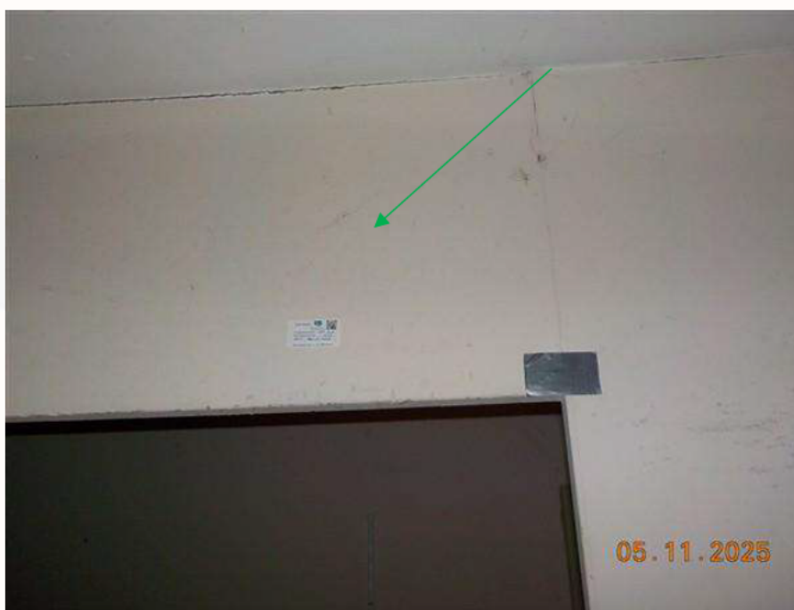
Foto 16: Bron B07, asbestvrij bovenlicht, cv ruimte kelder
