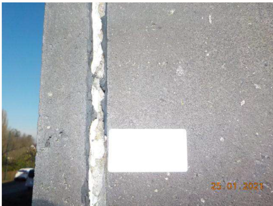
Foto 3: Bron B01, Buiten muur met asbesthoudende tegellijm
